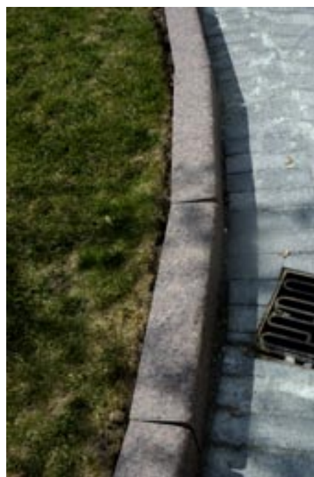
Fig 6.21 Vid montering av rak kantsten i snäv radie blir fogarna kilformade och intrycket av anläggningen förstörs.
