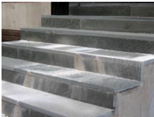
Fig 7.32 Misspyrdande salt- och kalkutfällningar, som är svåra att avlägsna. Sådana bildas när stora mängder vatten transporteras genom cementbruk.
