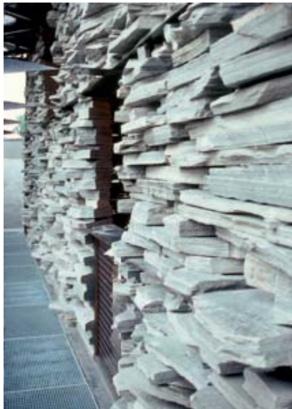
Fig 6.18 Glest staplad tormur av skiffer på bärverk av stål ger speciell effekt.
