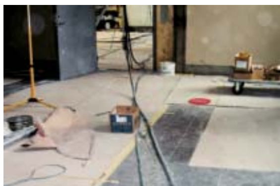
Fig 4.56 Avskräckande exempel där skyddstäckningen är utförd så att den inte klarar av att skydda golvet från aktuella belastningar.
