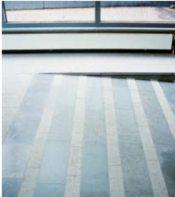
Fig 4.45 Lutande ramp av kalksten i kontorsentré. Läghuggna band utgör halkskydd och visuell markering.
