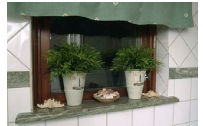
Fönsterbänk och bård av Kolmårdsmarmor blir ett effektivt inslag i den vita kaklade väggen.
